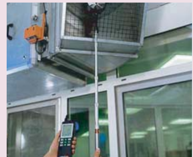
덕트 아울렛의 풍속 측정
